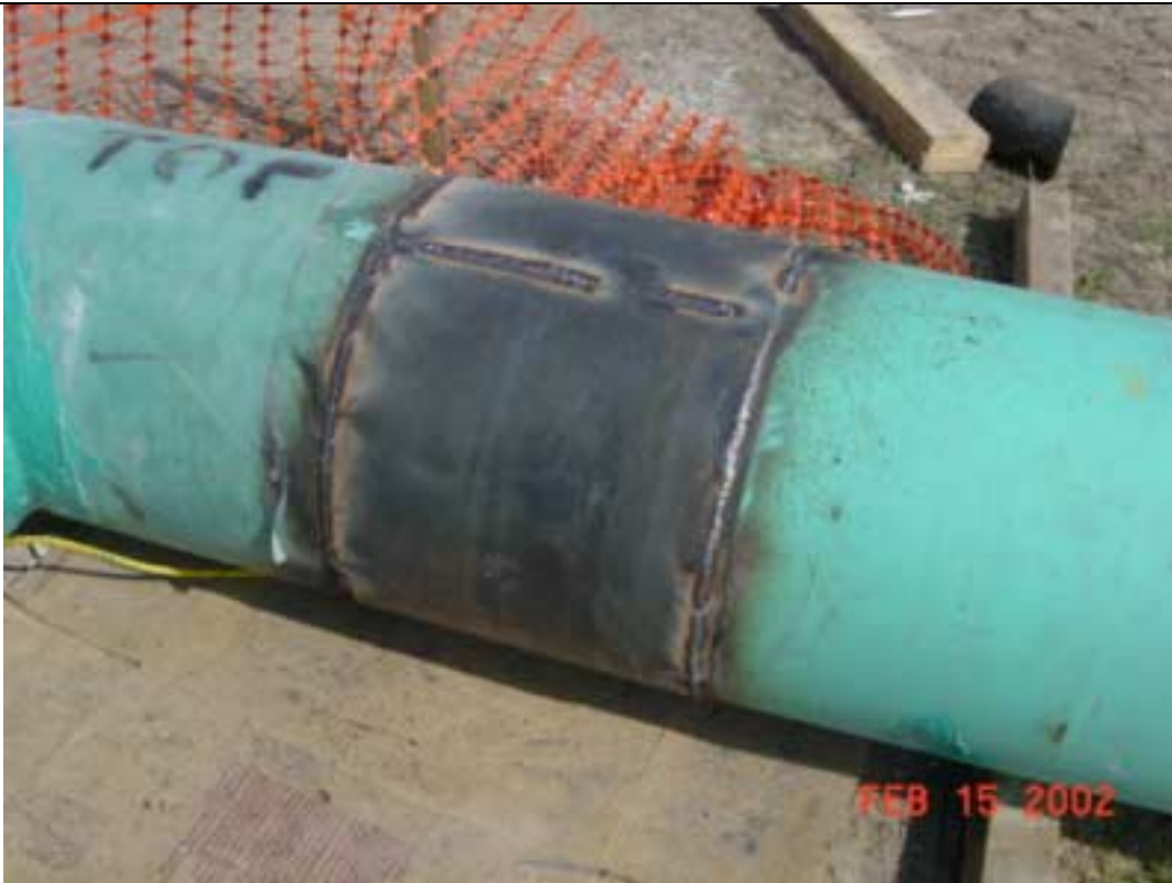
Steam conduit weld
